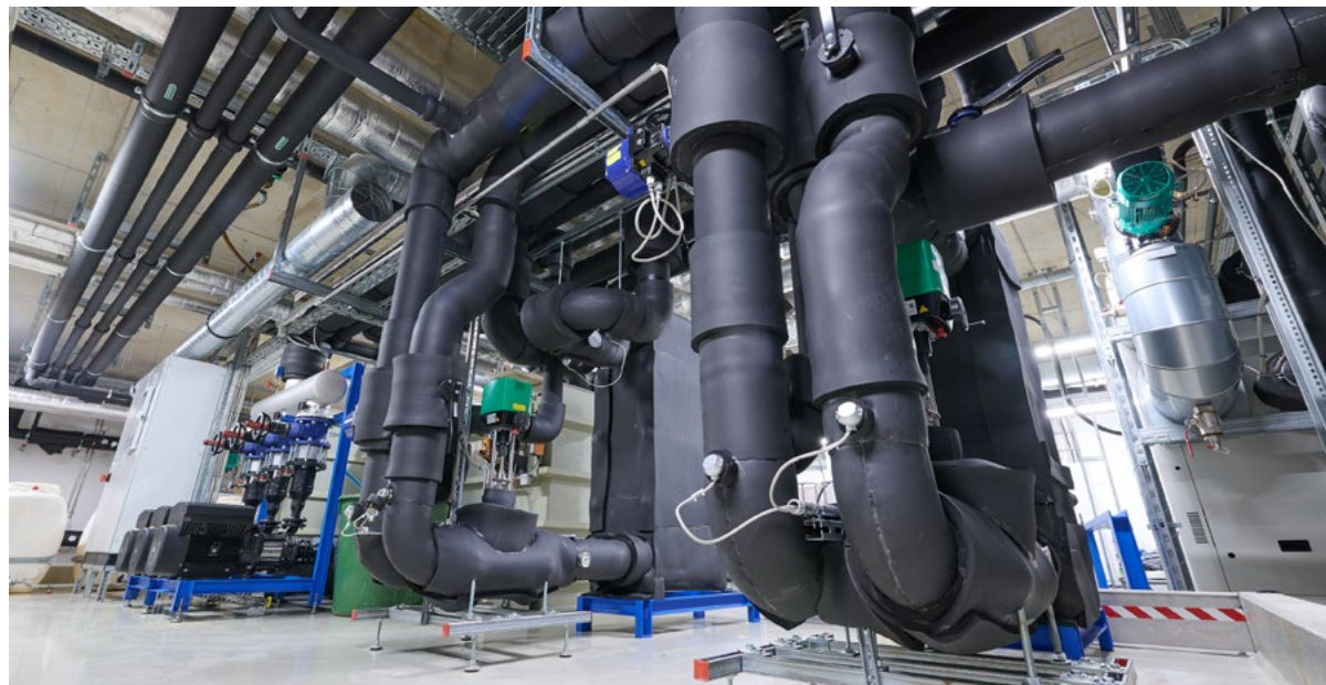
2024 haben wir eine effiziente Kühlanlage am Standort Parsdorf installiert. Die Maschinen und Anlagen der Fertigung können dadurch besonders nachhaltig mit Wasser aus dem eigenen Schluckbrunnen gekühlt werden.
