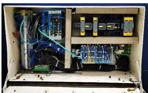
Schließensteuerung, komplett umgerüstet auf aktuelle MC6-Module
